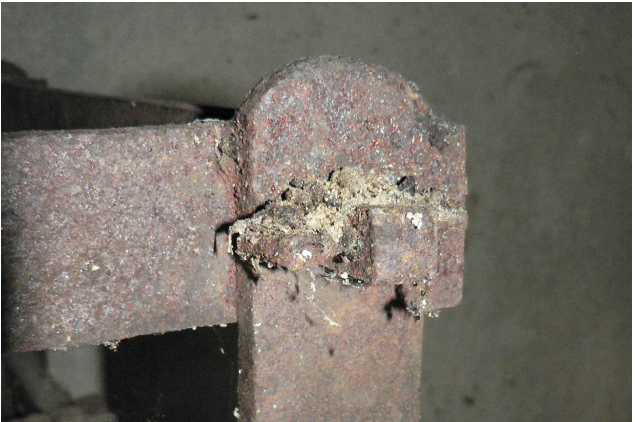
Koroze rámu stroje
